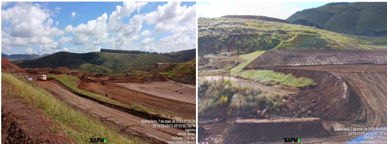
Figura 22: Condição recente e última da barragem Aredes.
