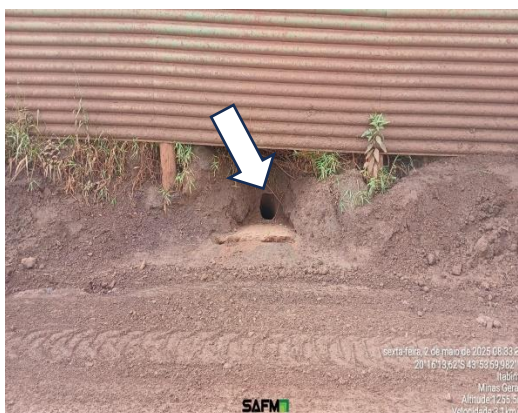
Figura 6-32: Ponto de desague da ITA-320 com tubulação que direciona água para jusante na cava do dique.
