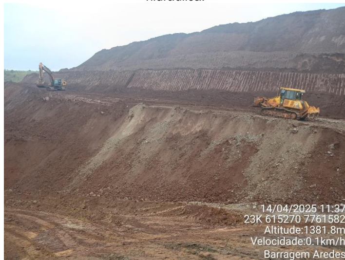
Figura 11: sequência ao retaludamento da praça 10 garantindo maior FS e corrigindo erosões oriundas das chuvas de março.
