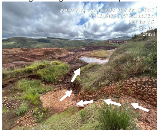
Figura 6-40: Saída da drenagem do extravasor principal da Barragem Aredes para o dique a jusante.
