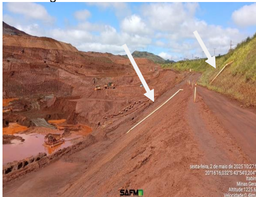
Figura 6-26: Encanamento direcionando a pluviometria da estrada para a cava do dique.
