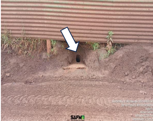
Figura 6-45: Ponto de desague da ITA-320 com tubulação que direciona água para jusante na cava do dique.
