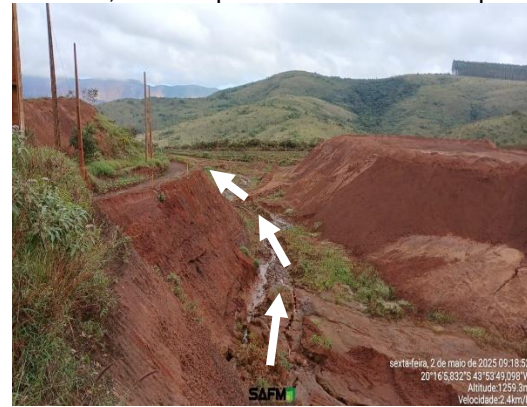
Figura 6-49: Drenagem oriunda do tubo extravasor da ITM indo em direção à Cava do Dique.
