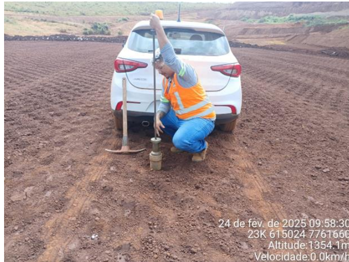
Foto 16: laboratorista terceirizado realizando ensaio de compactação (Hilf) a fim de liberação de camada.
