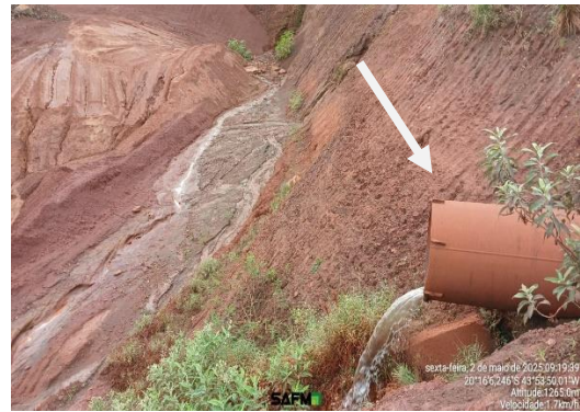
Figura 6-43: Tubo extravasor da água de montante da ITM.
